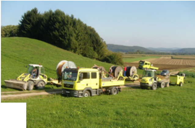
Abb. 11: Glasfaserausbau im Landkreis Waldshut
