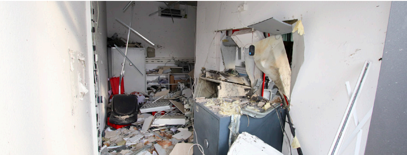
Die Explosion richtet einen hohen Sachschaden an und gefährdet Hausbewohner.
